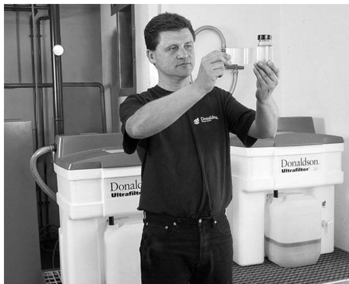
Donaldson-Servicetechniker Uwe Vogt prüft bei KSK Industrielackierungen GmbH & Co. KG, Geilenkirchen, das mit Ultrasep-Öl-/Wasser-trennsystem aufbereitete Kondensat.
